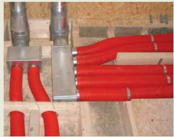
Gutes Klima und saubere Luft im ganzen Haus: Luftverteilsystem in Sparenlage.
