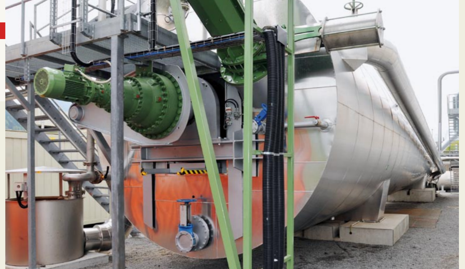
Der Fermenter bildet das Herzstück der Anlage.
