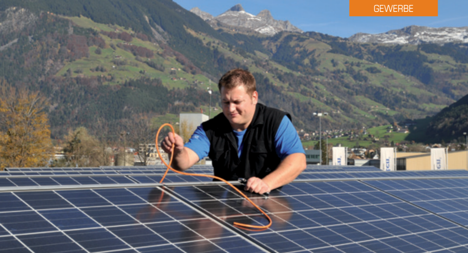
Jedes Haus ein kleines Kraftwerk: Photovoltaikanlage der Arnold AG.
