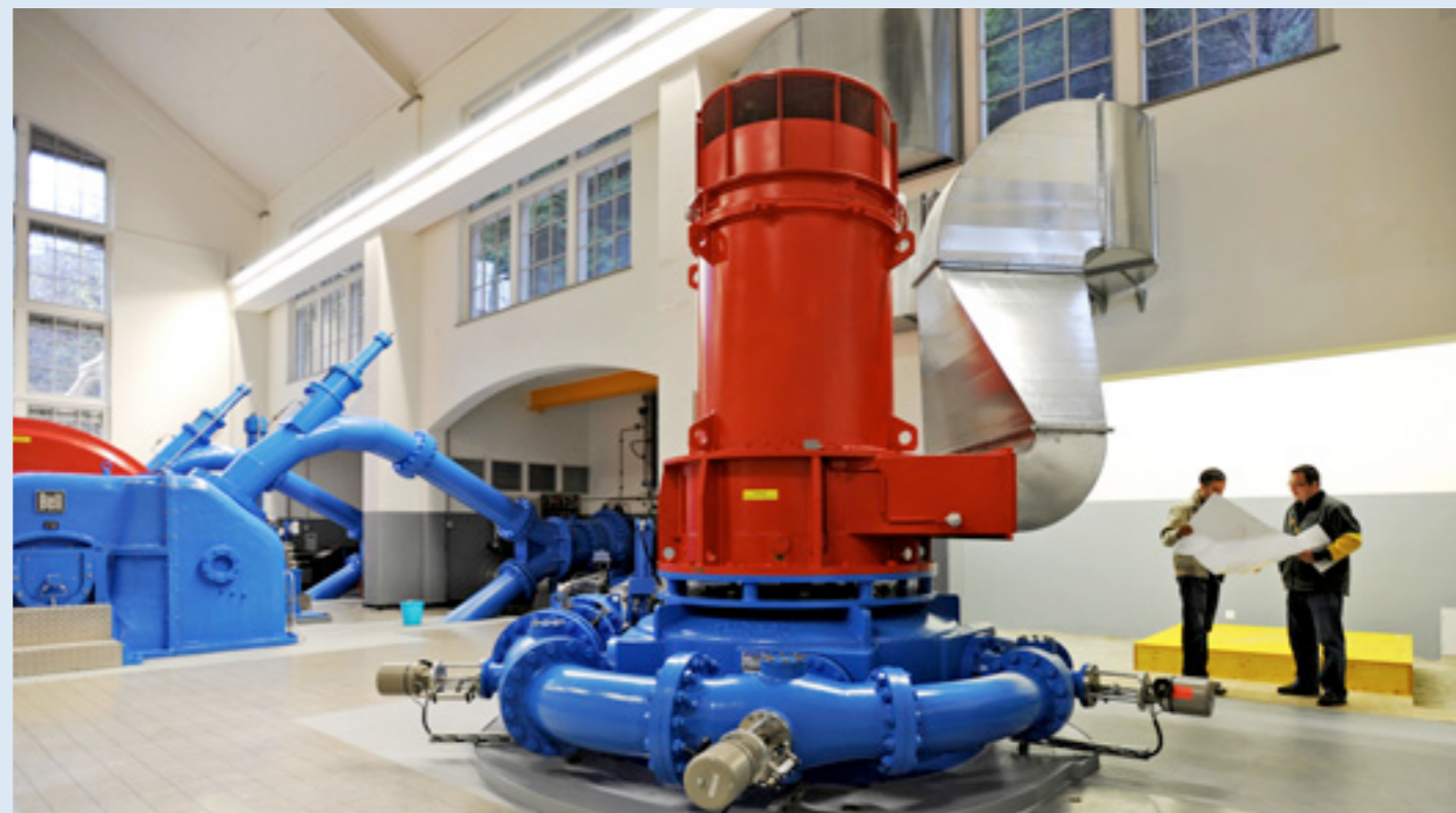
Zukünftig produziert die KW Seedorf AG im Gebäude des KW Isenthal erneuerbare Energie.
