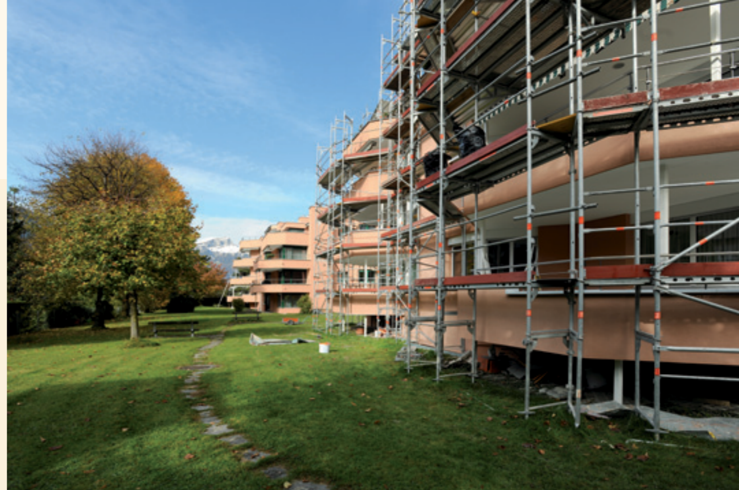
In der Überbauung Winterberg bleibt künftig die Wärme in den Häusern drin.
