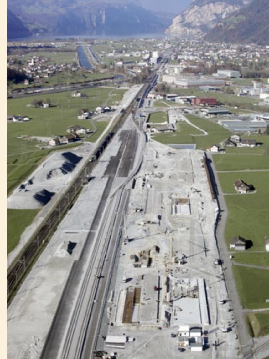
Dämme, Strassen, Schienen: Die Zukunft im Urner Talboden ist zurzeit eine grosse Baustelle.
