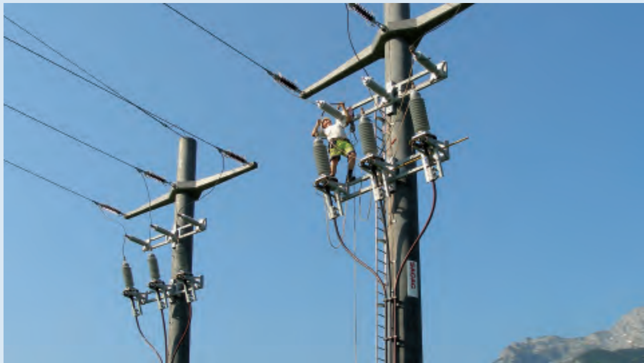
Arbeiten in luftiger Höhe: Ein Teil der Freileitungen in Schattdorf musste wegen der NEAT ersetzt werden.
