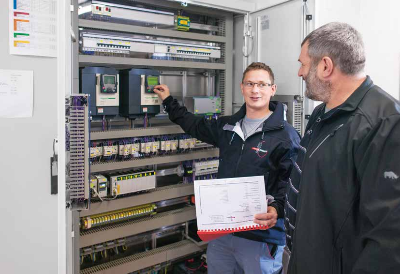
Eine neue elektronische Steuerung für die Wasserversorgung Attinghausen – für einen langfristig gesicherten Betrieb.
