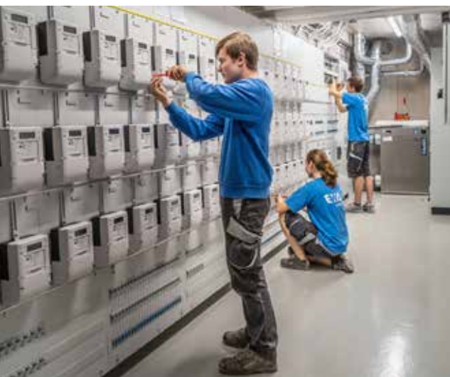
Smart Meter lösen die bestehenden Stromzähler ab.
