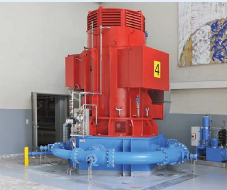
Die neue Maschine 4 im KW Bürglen – geplant vom EWA-Kraftwerkteam.
