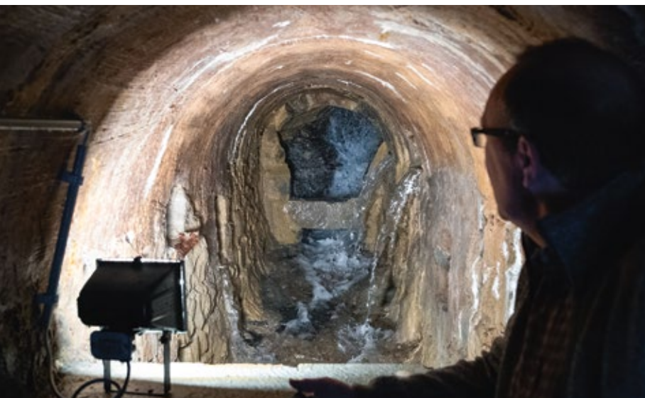
Einblick in die Wasserfassung im Bannwald Altdorf.
