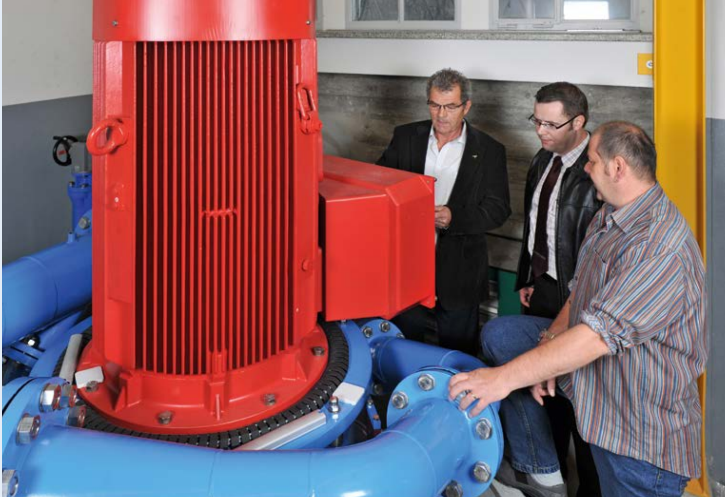
Der Verwaltungsrat des KW Seedorf (von links Fredy Zwysig, Werner Jauch und Stefan Aschwanden) besichtigt das neue Trinkwasserkraftwerk.
