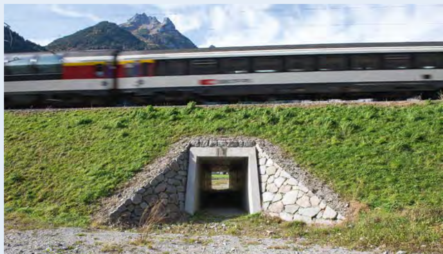
Kleintierdurchlässe verbinden die Lebensräume beidseitig der Gleise.
