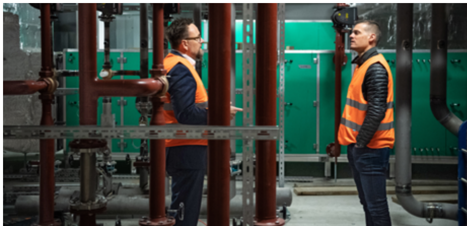
Die neue Technikzentrale versorgt künftig den gesamten Gebäudekomplex mit Energie, Wärme und Kälte.
