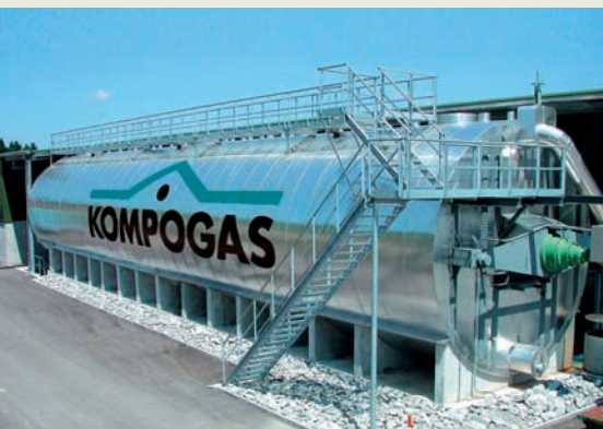
Wenn alles nach Plan läuft, wird die erste Urner Biogas-Anlage im Sommer 2008 in Betrieb genommen.
